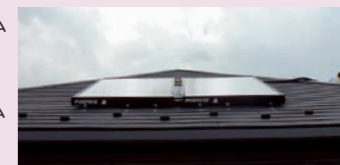
屋根南面に熱交換型太陽熱温水器
